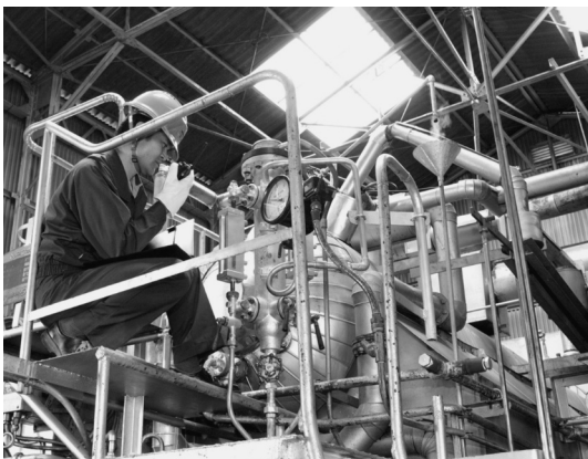
写真1 ボイラ診断シーン
