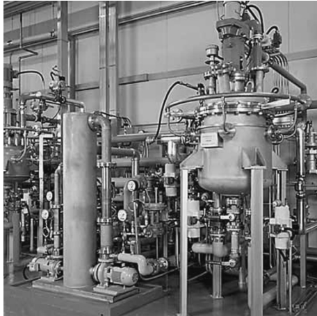
写真3 真空蒸気加熱・気化冷却システム
