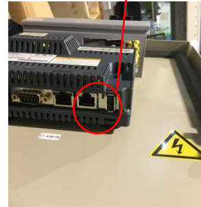
Figura Dentro del panel de control
