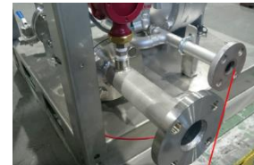
Tubería salida condensado
