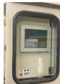
Panel de control para las especificaciones exteriores
